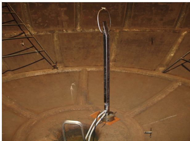
Рисунок 3. Фотография измерительной планки, установленной внутри камеры 13ЯЗ.
